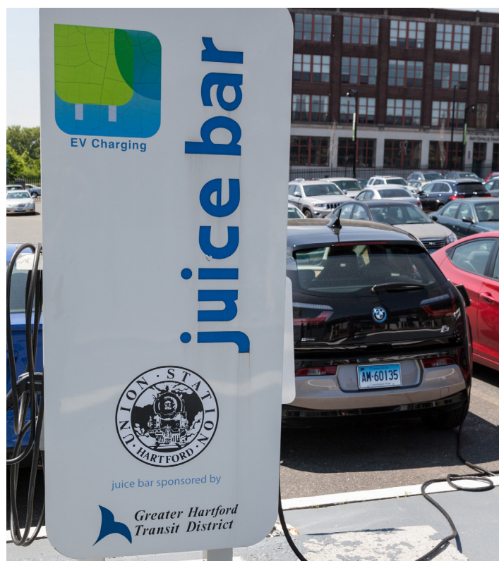
Figura 01.11 — Estaciones de cargas de vehículos eléctricos (EV) de Hartford (Garage Juice Bar)
